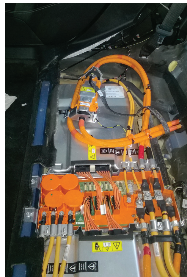
Advarselsskilte med høj spænding i motorrum.
